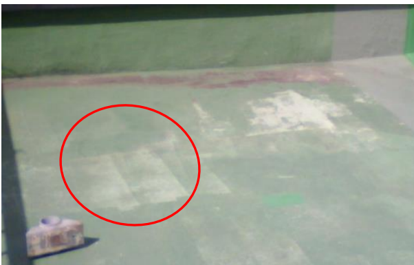
ウレタン防水 漏水調査
