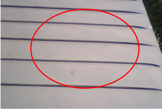
縦葺きカラー亜鉛鉄板 漏水調査
